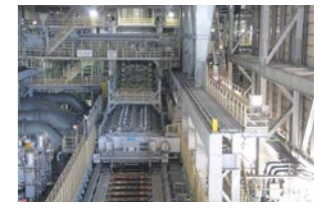
倉敷 第7連続製造設備
