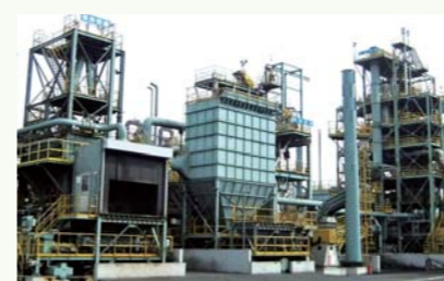
フェロコークス製造設備
