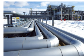
天然ガスプラント
