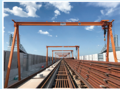
▲ 福井軌道基地レール置き場
