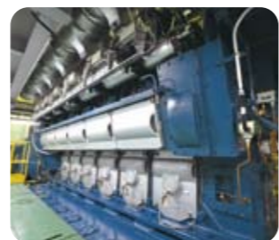
ガスエンジン発電機
