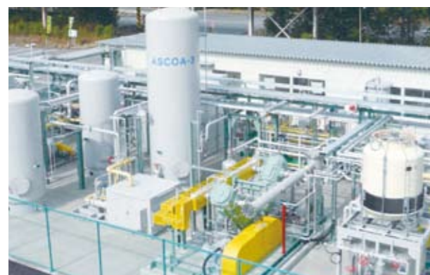
PSAによるCO 2 分離試験装置(福山地区)
