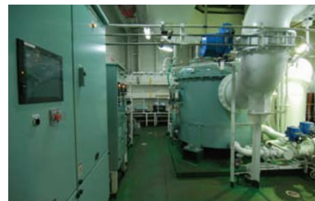
バラストエース装置(フィルターおよび制御盤)
