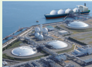
E LNG再出荷設備(袖師基地)
