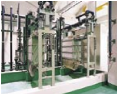
高負荷膜処理（し尿処理）設備
