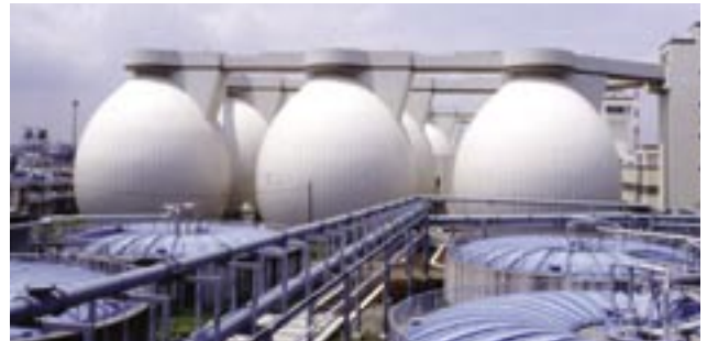
下水汚泥メタン発酵設備
