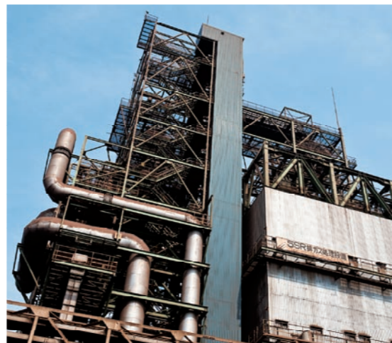
焼結炉排ガス処理設備:西日本製鉄所(福山地区)活性コークス方式の例
