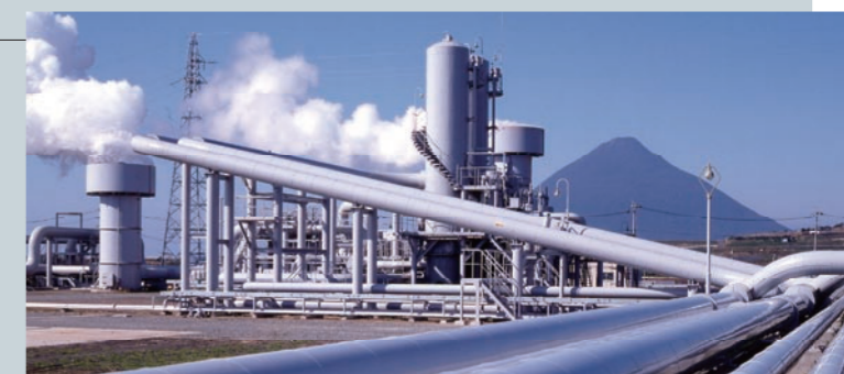
山川地熱発電所(鹿児島県指宿市)
