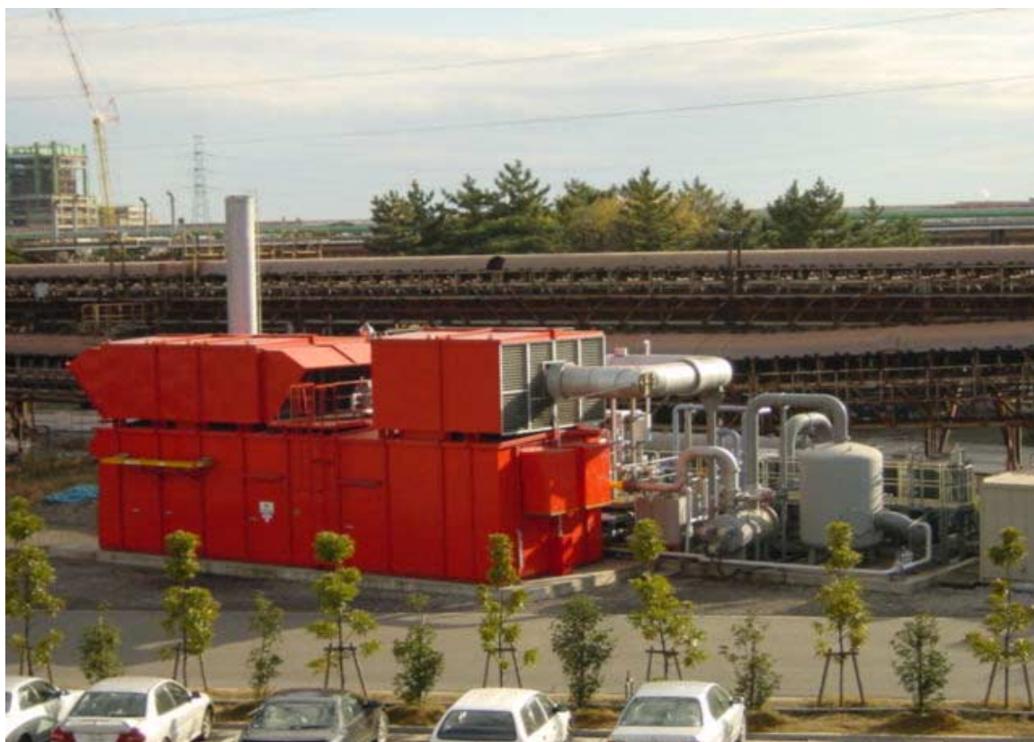
川鉄サーモセレクトに併設された「高効率ガスエンジン発電設備」
