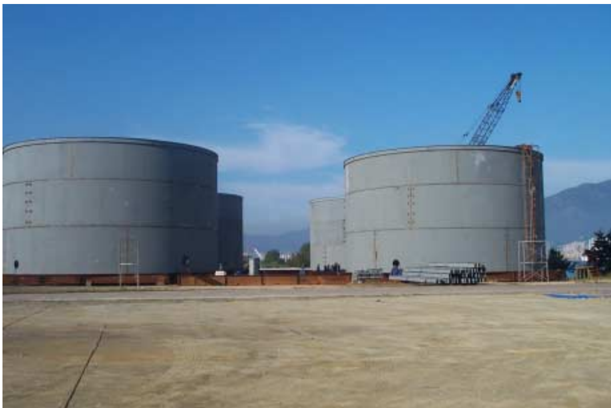
【写真 1】メルトピッチ出荷用タンク4基の全景。4基共に組み立てがほぼ完了した状態。
