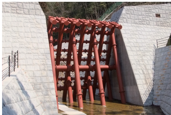
鋼製透過型砂防堰堤
