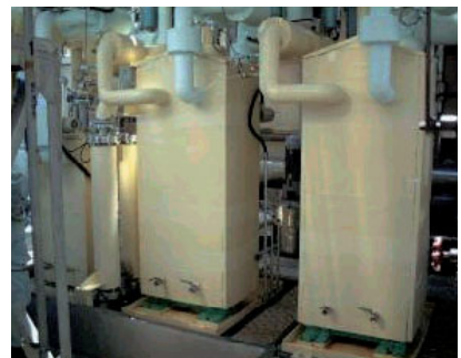
省エネ空調システム
