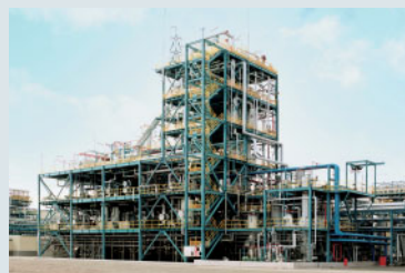
DME100トン/日直接合成実証プラント(北海道白糠町)
