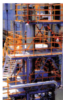
循環流動層試験装置 (バイオマス処理量:150kg/h)
