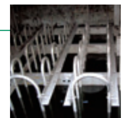
間接冷却設備(内部)
