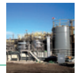
シアン水処理設備
