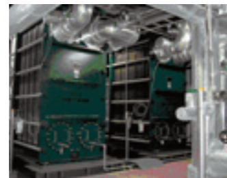
水和物スラリ蓄熱空調システム
