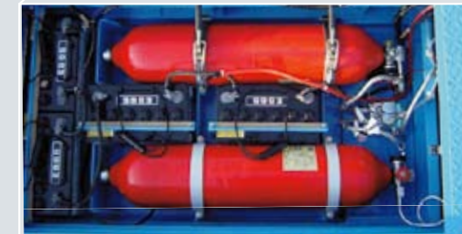
水素ガス容器拡大(荷台内部)
