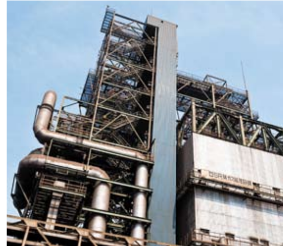
焼結炉排ガス処理設備:西日本製鉄所(福山地区)活性コークス方式の例
