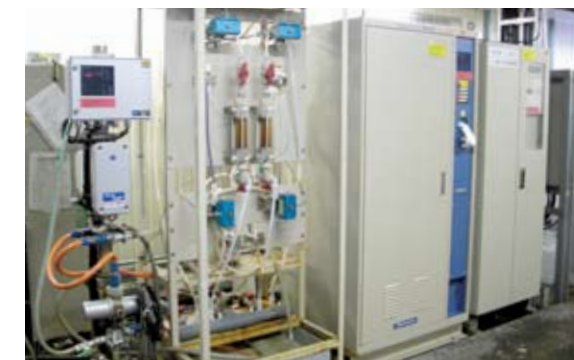
排水自動分析装置:東日本製鉄所(千葉地区)の例
