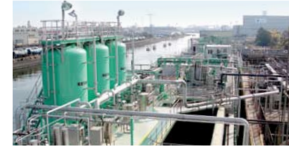
排水処理設備:東日本製鉄所(千葉地区)排水中窒素処理設備の例
