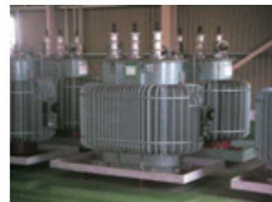
PCB機器保管庫と機器保管状況: 西日本製鉄所福山地区
