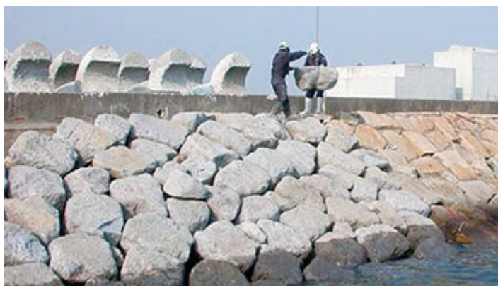
鉄鋼スラグ水和固化体製人工石材を用いた港湾修繕工事
