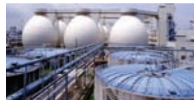
下水汚泥メタン発酵設備
