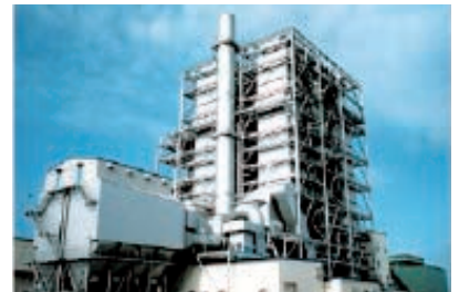
循環流動層(CFB)ボイラ発電
