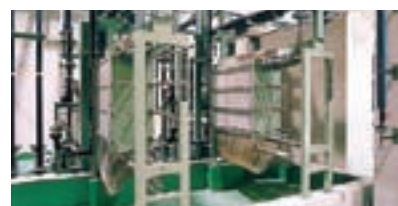
高負荷膜処理(し尿処理)設備
