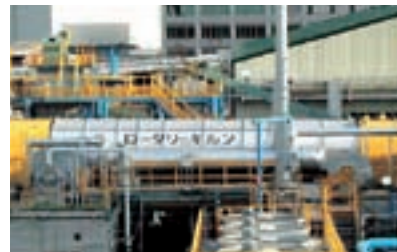
塩化ビニル脱塩素実証プラント
