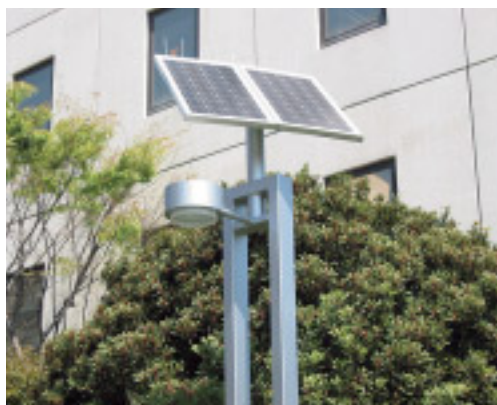
鶴見事業所に設置されたソーラー街路灯
