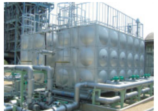
(株)クラレ 生産・技術開発センター殿(倉敷市)
