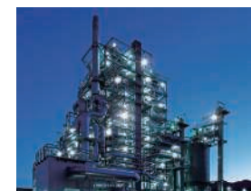
バイオマス発電設備
