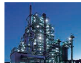
バイオマス発電設備
