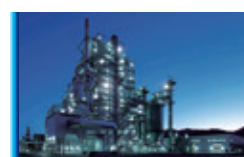
バイオマス発電設備
