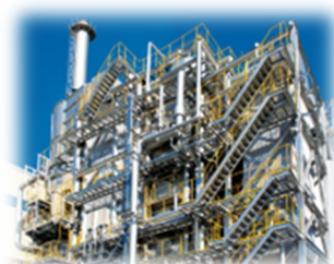
廃棄物処理 プラント
