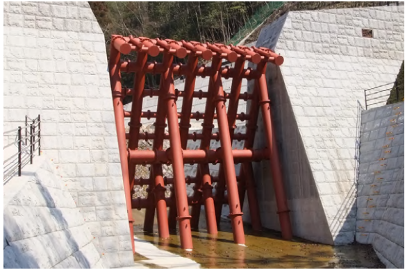
鋼製透過型砂防堰堤
