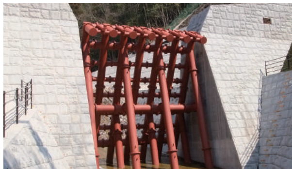
鋼製透過型砂防堰堤
