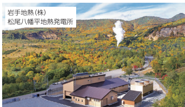
地熱発電プラント
