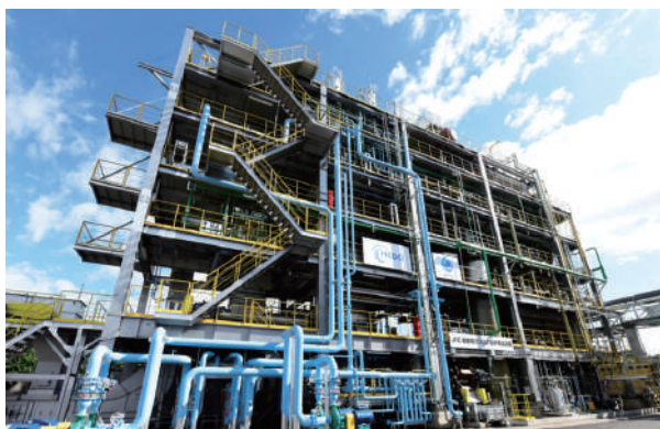
小型炉実証設備
