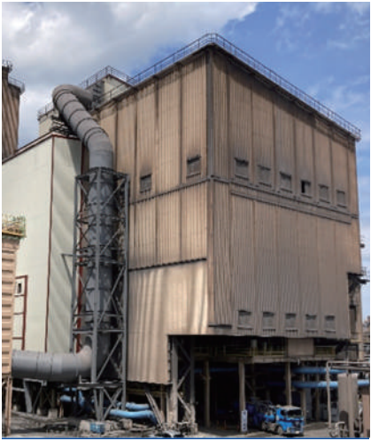
千葉地区第4製鋼電気炉の外観
