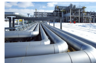
天然ガスプラント
