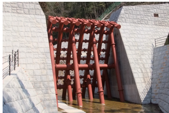
鋼製透過型砂防堰堤
