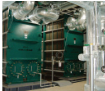
水和物スラリ空調システム
