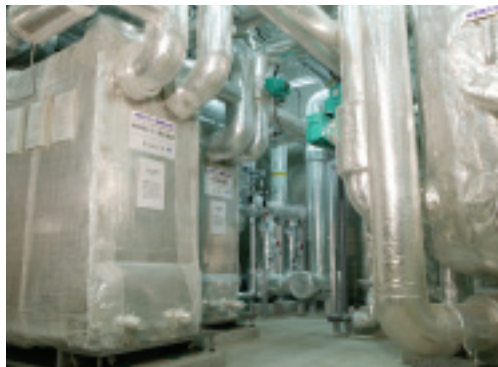
水和物スラリ蓄熱空調システム
