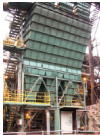
集じん設備: 西日本製鉄所 (福山地区)の例
