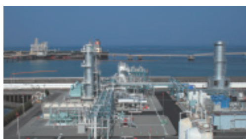
VOC回収設備
