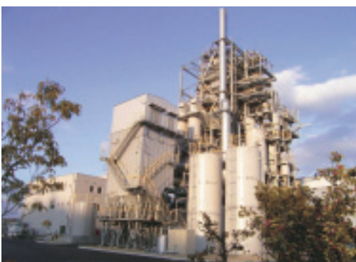
バイオマスボイラー
