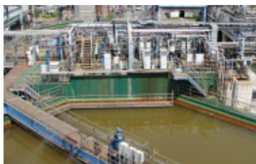
水処理設備:東日本製鉄所(千葉地区)の例
