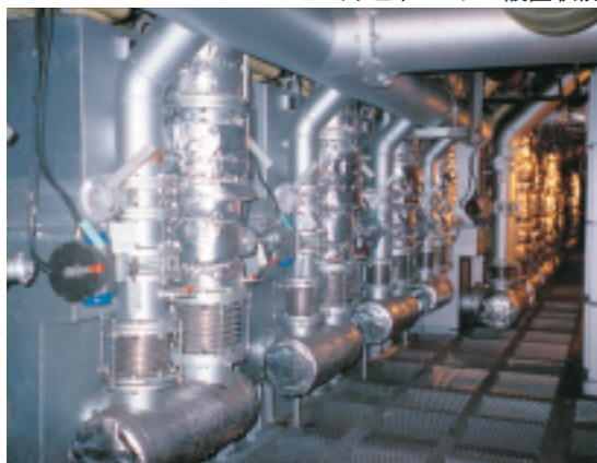
リジェネバーナー設置状況
