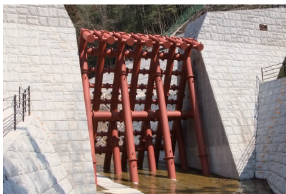
鋼製透過型砂防堰堤
